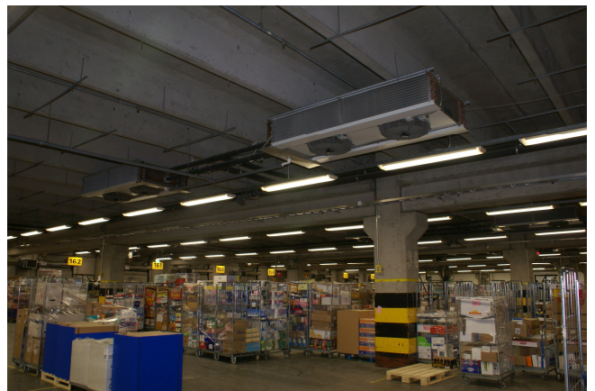
Keslog KV2 keskusvarasto Vantaan Hakkilassa, 2009-2010 rakennettu konehuone, 6 x 500 kW Grasson NH 3 -chillereitä sekä lähetysalueen ilmanjäähdyttimiä
