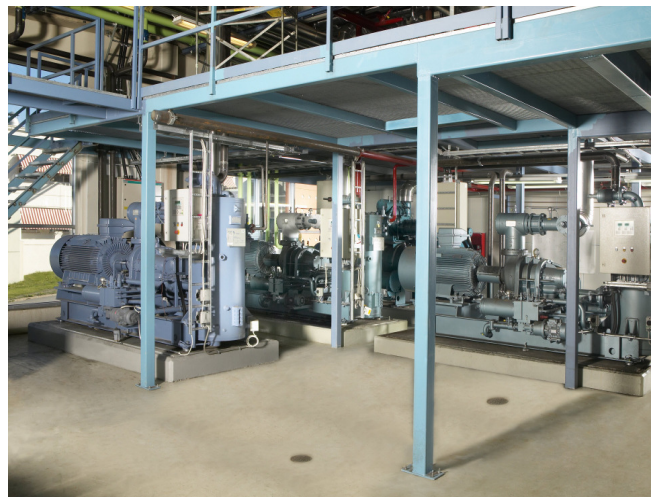
2002 rakennettu -10 °C konehuone, 4 x 1MW Grasson ruuvi-kompressoria
